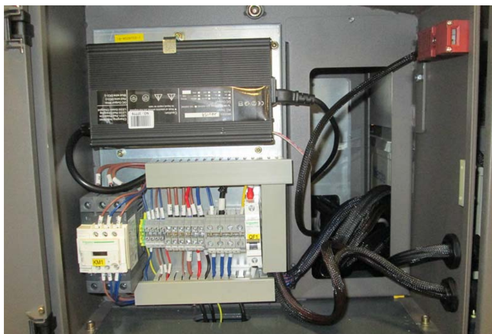
Figura 5 - 4 Recinto eléctrico del lado derecho
