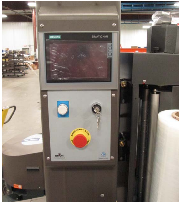
Figura 3 - 2 Panel del operador
