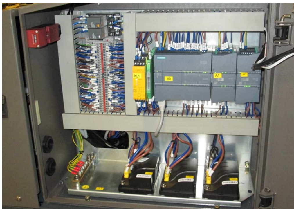
Figura 5 - 3 Recinto eléctrico del lado izquierdo
